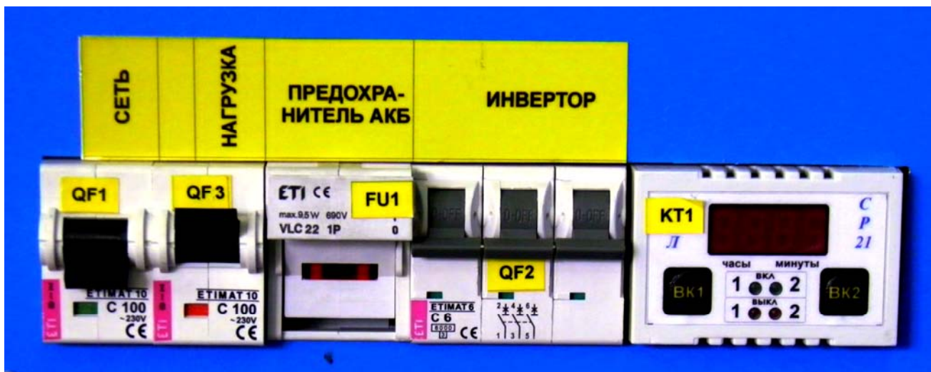
Рис. 6 Расположение автоматических выключателей на панели управления
