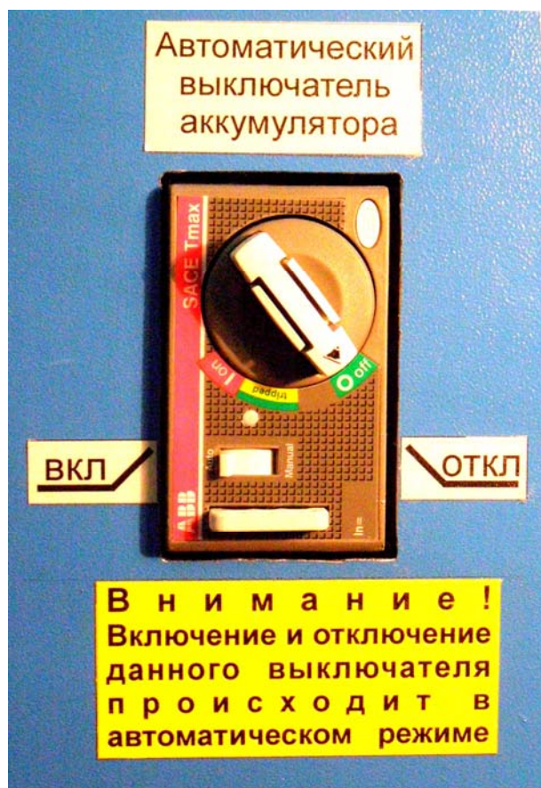
Рис. 5 Автоматический выключатель аккумуляторной батареи
