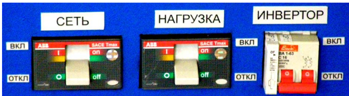
Рис. 4 Расположение автоматических выключателей на панели управления
